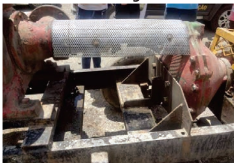
Foto 5 – Proteção fixa – eixo da bomba d'água
