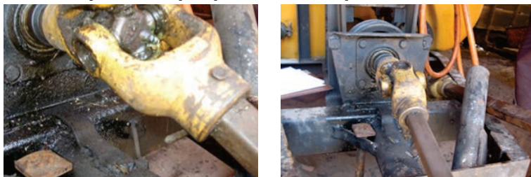
Foto 1 - do conjunto tanque/pressurizador que ocorreu o acidente
